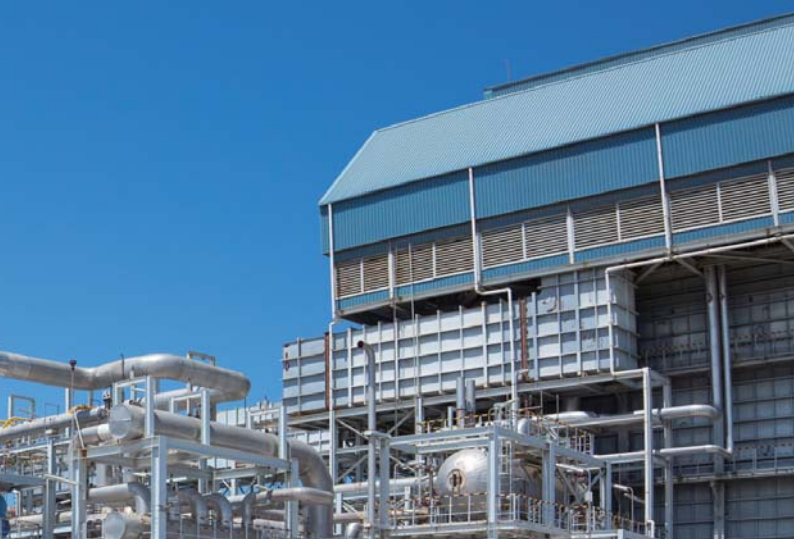
◀ 海南二期甲醇裝置
