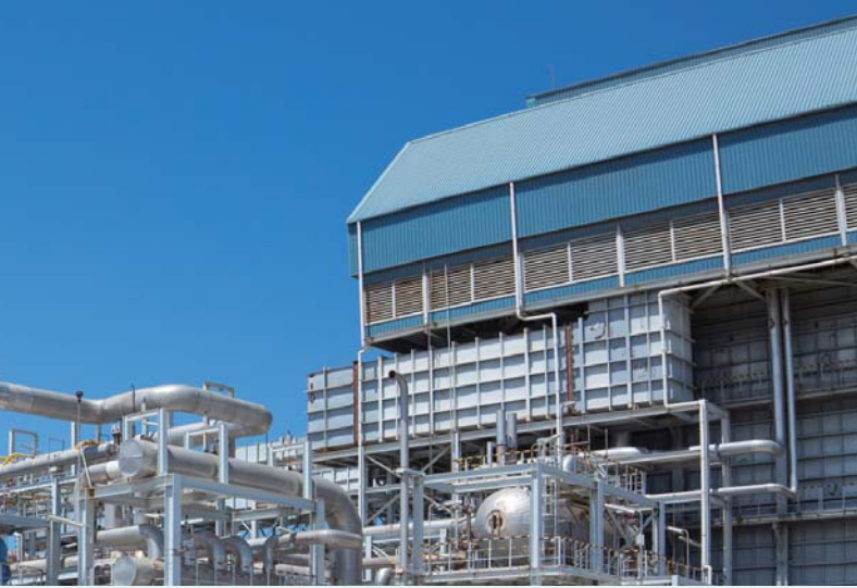
◀ 海南二期甲醇裝置
