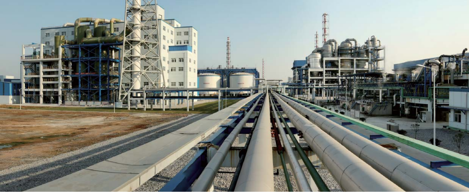
大峪口化工磷酸主裝置
